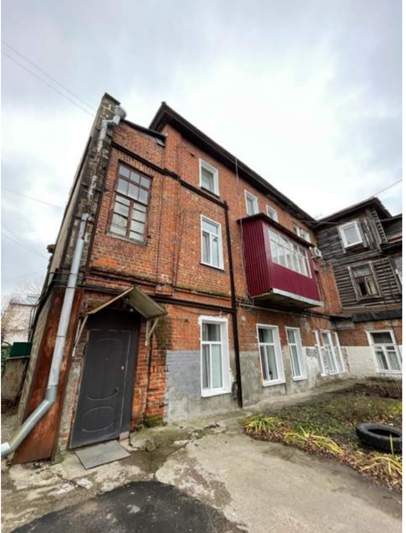
Фото № 13. Прямоугольная форма оконных и дверных проемов с клинчатыми перемычками северного фасада основного объема.
